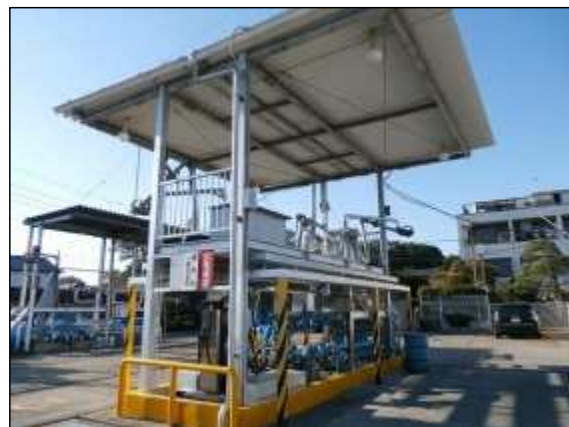
《災害時燃料備蓄拠点》
